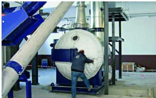
Moderne Müllbeseitigung: Die Ingenieure von AVA econ Industries aus Herrsching bei München konzipieren Anlagen zur Beseitigung von Sondermüll – für alle Branchen maßgeschneidert
