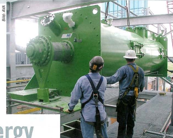
Mischer zur Homogenisierung von Sondermüll während der Montagephase.
